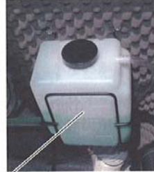
冷却水の量を確認
